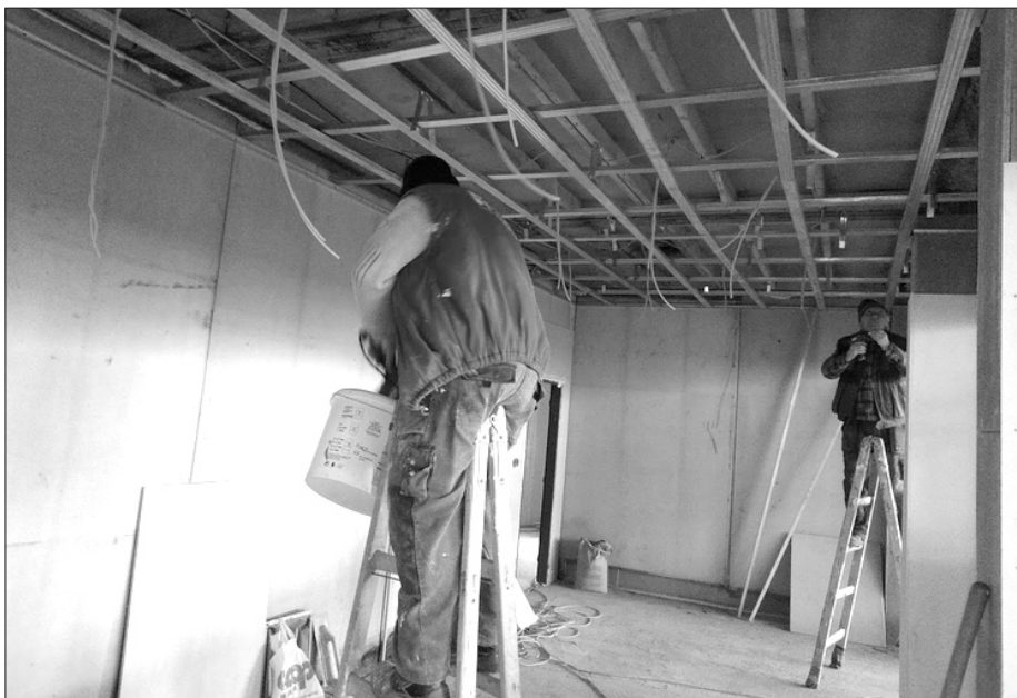
A jelenleg folyó egyik legnagyobb városi beruházás a T18-as tornaterem felújítása. A csaknem 1 milliós beruházás várhatóan márciusban fejeződik be. (fotó: ik)
