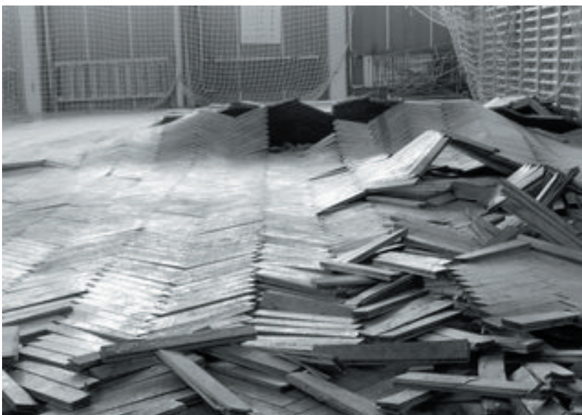
V časti, kde kvôli poruche strechy zatieklo, je podlaha úplne zničená.
