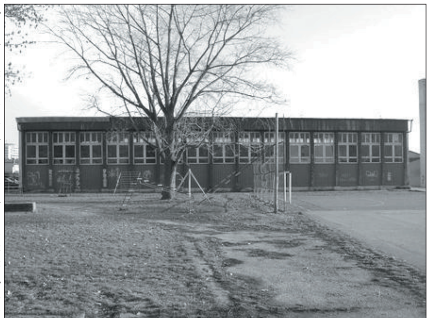
A valaha szebb napokat látott tornaterem megsérült tetőszerkezetét ideiglenesen egy ponyvával takarták le. A javítás azonban elkerülhetetlen. Foto: (ck)
