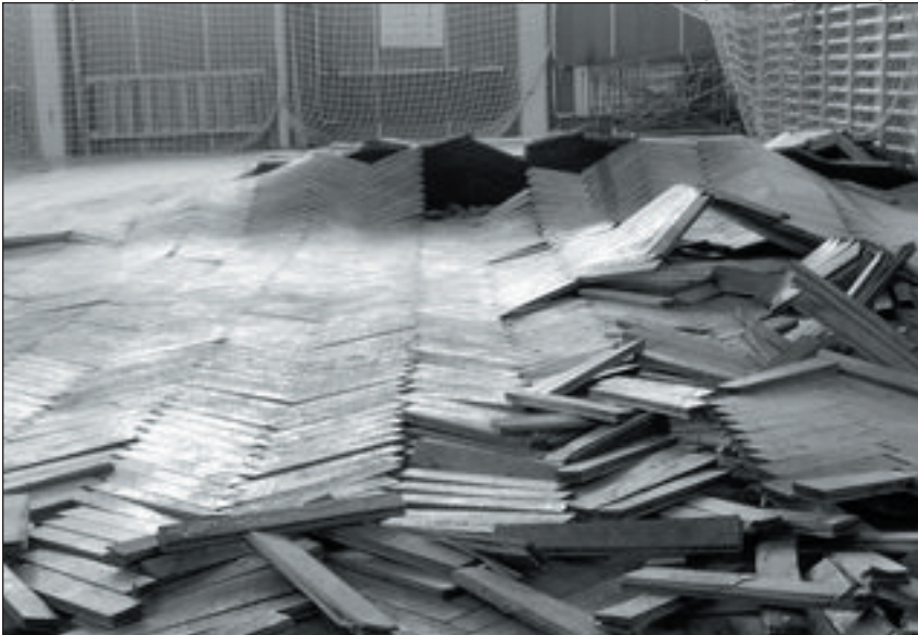
A tornaterem egyik részében a tető beázott, a padlózat teljesen tönkrement Foto: (ck)
